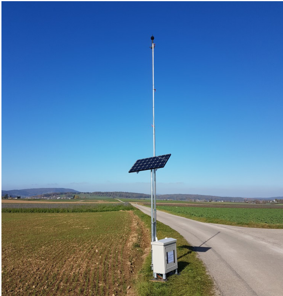
Abbildung 2: Beispiel einer Messstation bestehend aus Mikrofon, Solarpanel und Messschrank (© Empa)
